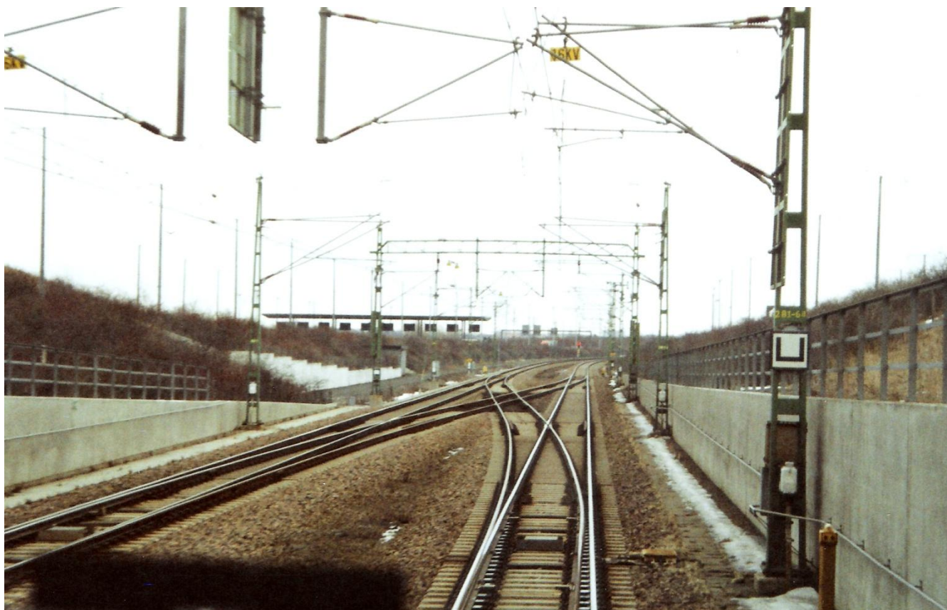
Et smukt Diamantkryds på Lernakken. Her begynder den svenske kørestrøm. Oppe i udliggøren hænger der et lille gult skilt, som fortæller at spændingen er 1,5 kv.
